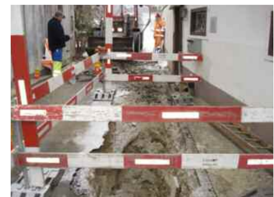
Im nördlichen Teil der Hauengasse ist noch die alte, sanierungsbedürftige Wasserleitung in Betrieb. Bild ZVG
